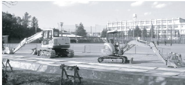
↑袋井商業高校の雨水貯留施設。
